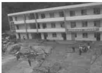
图 13 教学楼地基变形 (彭州市白鹿中学)
