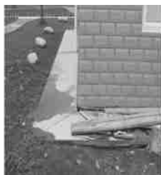
图 14 地基砂土液化 (都江堰中兴镇九年制学校)
