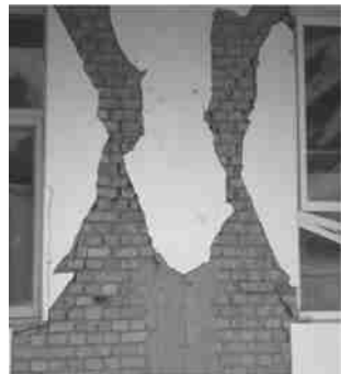
图6 独立窗间墙X形裂缝 (彭州市龙门山镇中心学校)
