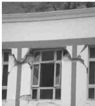
图7 独立窗间墙水平裂缝及X形裂缝(临近建筑)
