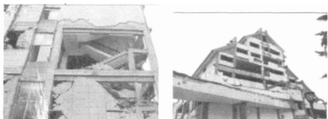
图1 框架结构的填充墙开裂和破坏
