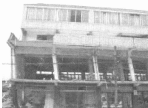
图2 框架梁和楼板过强导致出现柱铰破坏机制
