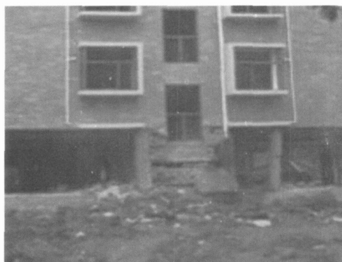
图 18 底层填充墙破坏严重 (震害图片)
