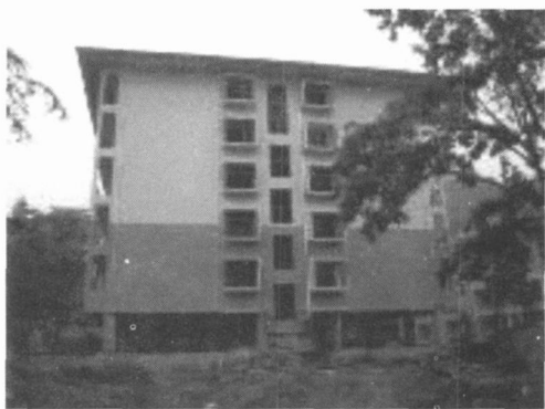
图3 上部填充墙导致底部框架出现柱铰破坏机制
