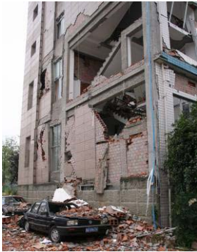
都江堰填充墙发生破坏
