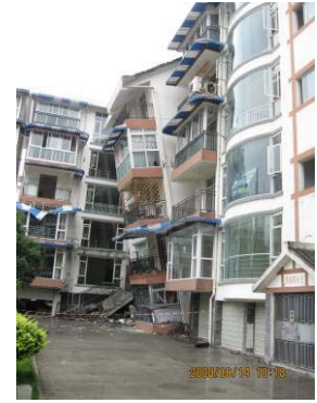
都江堰某住宅小区框架结构底层破坏
