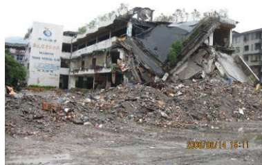
都江堰某公共建筑框架结构局部垮塌
