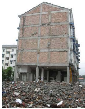
都江堰某住宅小区框架结构倒塌
