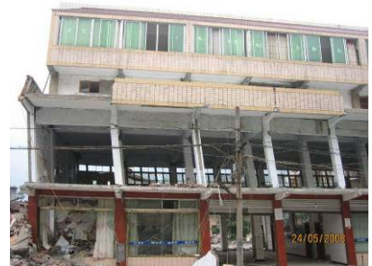
南坝镇-强梁弱柱导致柱顶产生塑性较
