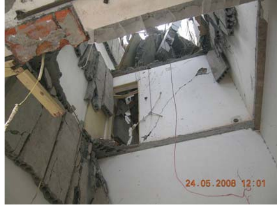
图4 安县秀水镇广电楼出屋面信号塔砸穿西侧两个开间造成三人死亡
