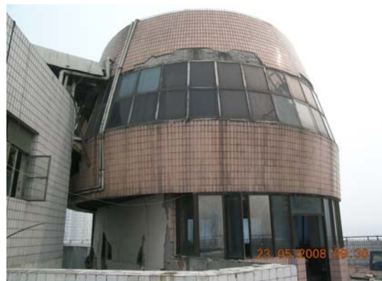
图2 绵阳商场12层出屋面圆形会议室破坏
